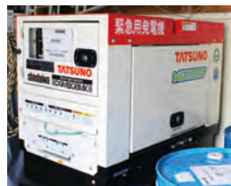
非常電装置を導入
